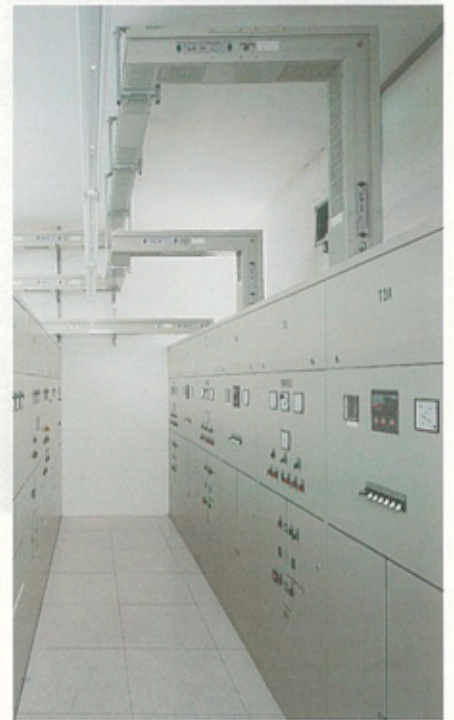
▲ Niederspannungsfeld mit Trafo-Einspeisung und Stromschienen zu den Niederspannungs-Verteilern
